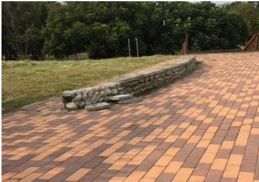
既有座椅損壞
