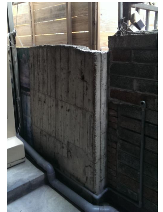
東義段 261 地號後方圍牆越界現況
